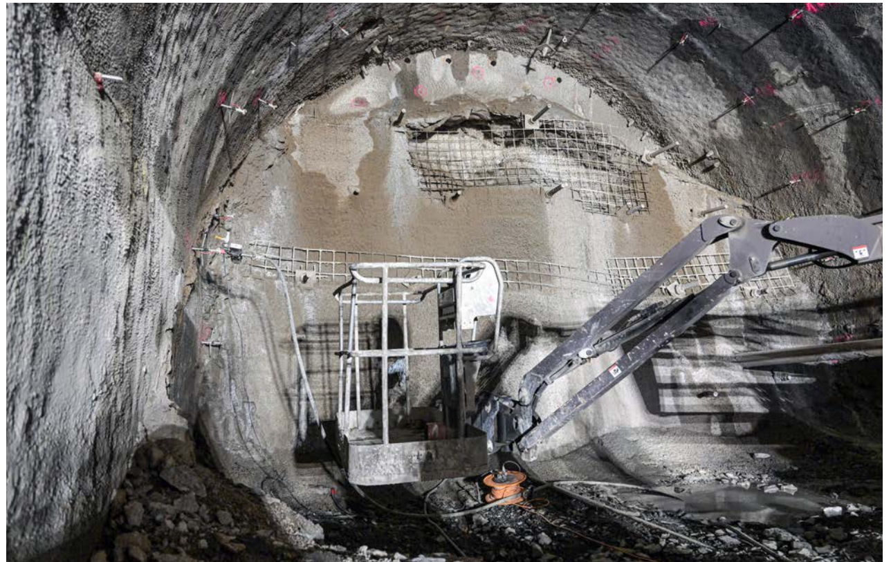
Der Nordeingang des Tunnels: Die Einsturzstelle ist auf einer Länge von vier Metern mit einer provisorischen Stützwand gesichert
